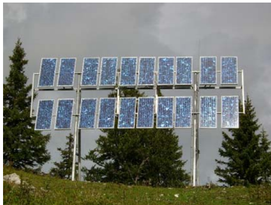
Die neue Photovoltaik-Anlage
